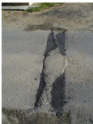
Oprava do 600 Kč
