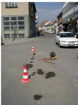
Oprava do 200 Kč
