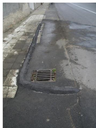
Oprava do 1.000 Kč
