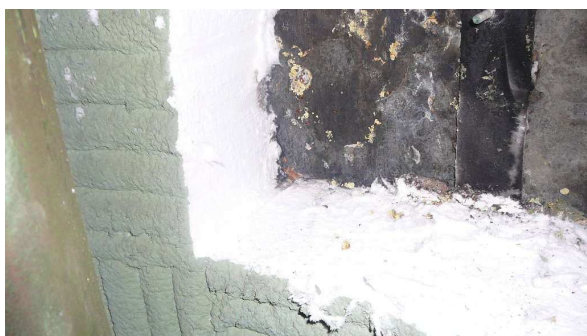
Stav izolace a pláště pece (4x)
